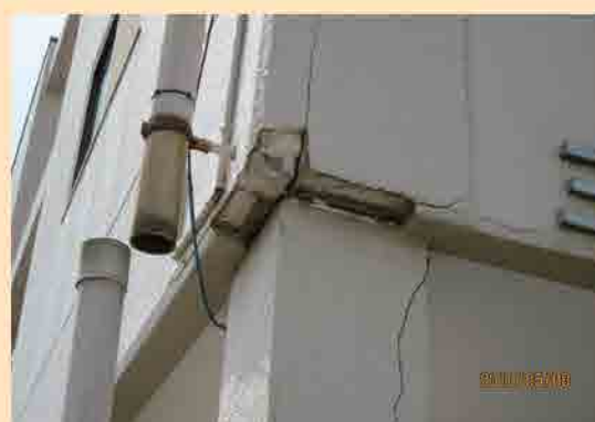
◀鉄骨ALC造の建物には、出隅部分の亀裂やALC板破損が多く見られた
