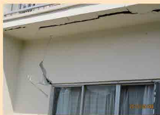
◀木造2階建ての共同住宅は、ベランダ下部と開口部のモルタルに大きな亀裂が
