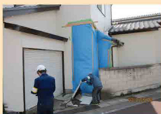
▲モルタル塗りの外壁が、地震の揺れによってゆがみ、大きく剥がれ落ちてしまった。応急処置の様子が痛々しい
