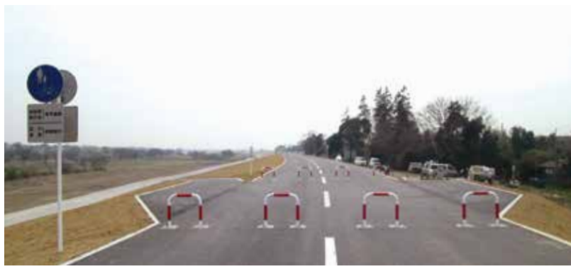
▲堤防天端に走る自転車/歩行者用道路も広く使いやすくなった。日頃何気なく使っているインフラは、みな土木工事あつてのもの
