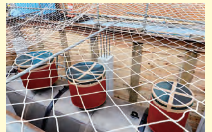
▲重油の備蓄設備は引き続き工事中。1万ℓという大量の重油は、主に有事の際の自家発電に備えてのもの
