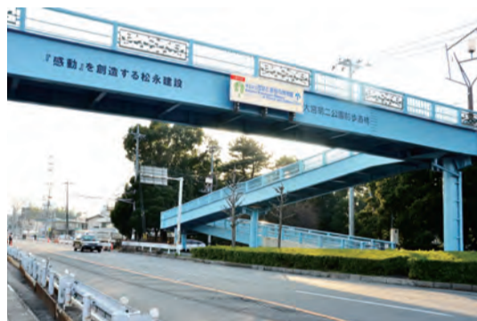
▲大宮第二公園と第三公園の間を渡している歩道橋。通りがかりの際はぜひご覧を！
